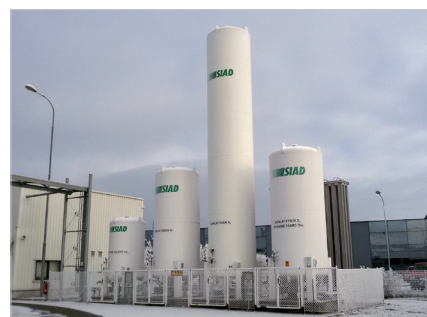
Obr. 2: Instalovaná zařízení v roce 2017 (Foto: Petr Halla)
