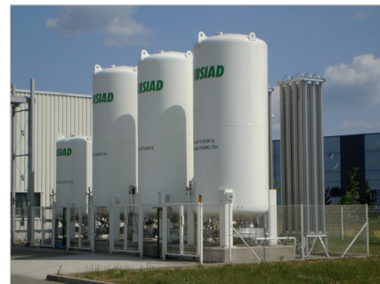
Obr. 1: Instalovaná zařízení v roce 2005 (Foto: Petr Halla)
